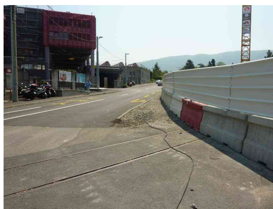
Figure 5 : manque de signalisation. bâtiment TPG
