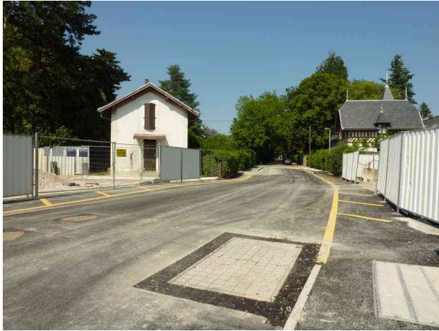
Figure 36 : marquage jaune qui remplace le trottoir
