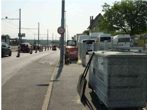
Figure 37 : obstruction du trottoir
