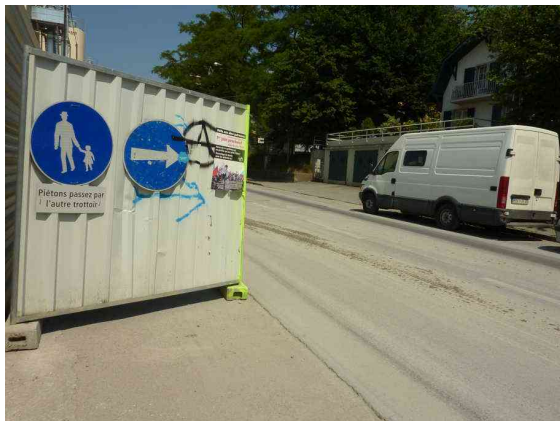
Figure 18 : passage piéton manquant
